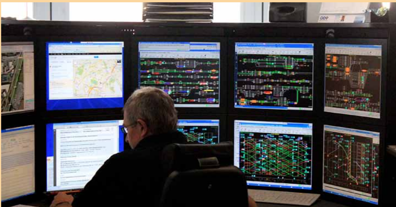
V nové budově na Laxenburger Straße je umístěna také centrála provozního řízení (Betriebsleitzentrale, BLZ) s dálkovým ovládáním stavědel v celé východní části země (snímek z března 2013)
