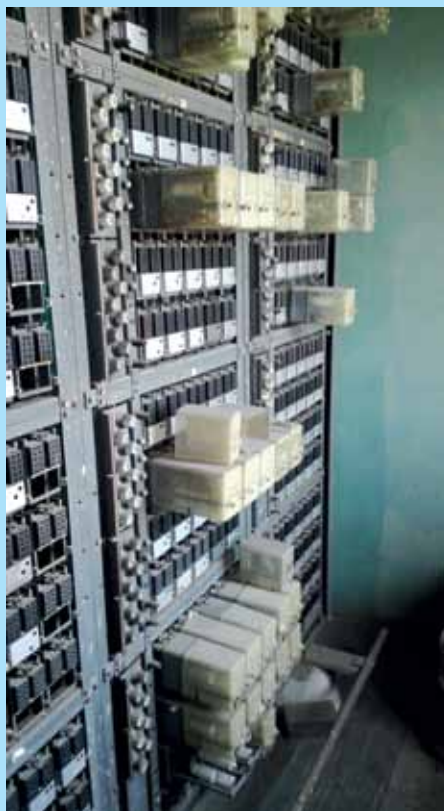
Zoufalý stav stavědlových ústředí
