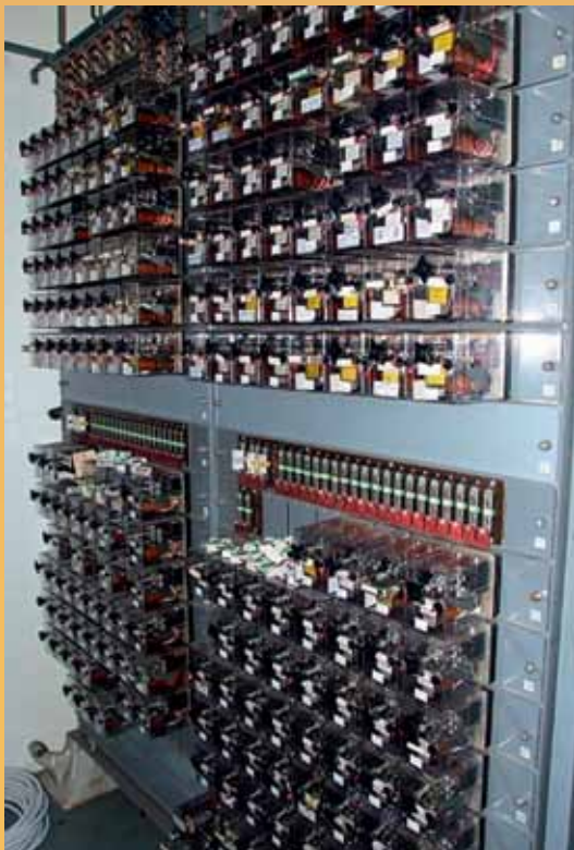
Reléové zabezpečovací zařízení AŽD 71
