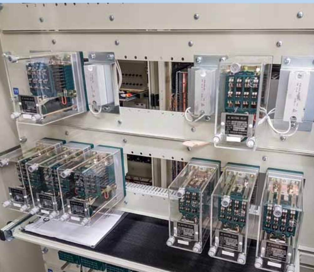
Instalovaná relé sloužící jako interface pro úvazku na stávající zabezpečovací zařízení Nippon Signal ve stanici Muratli Muselles
