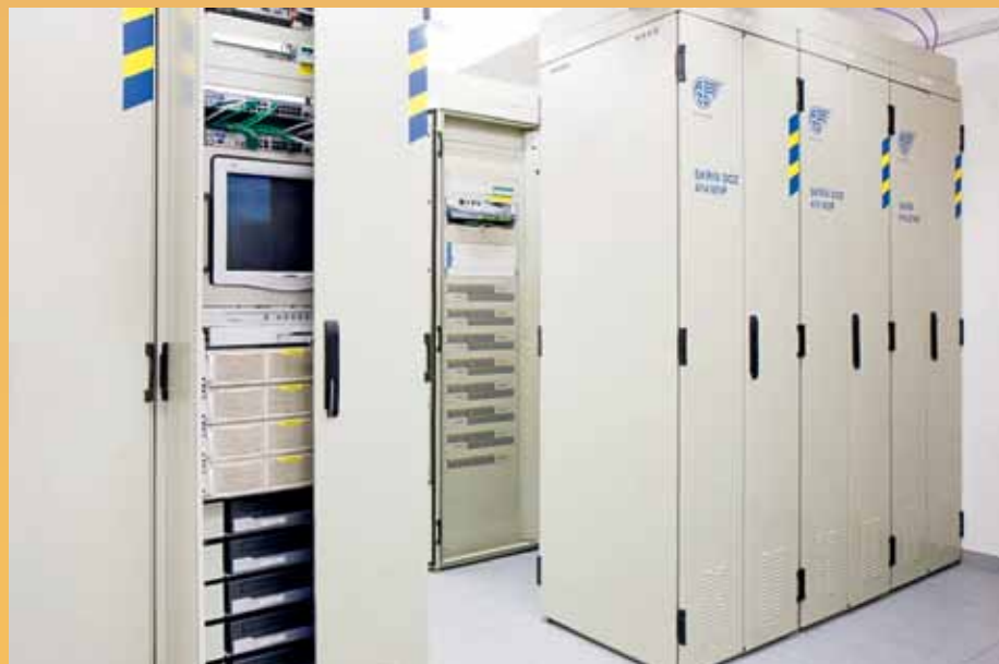
Technologické zařízení Centrálního dispečerského pracoviště Přeřov
