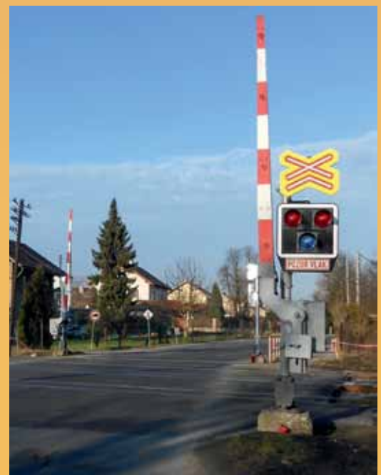
Přejezdové zabezpečovací zařízení světelné AŽD Praha s polovičními závoryami
