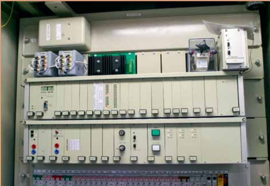
Přejezdové zabezpečovací zařízení světelné elektronické
