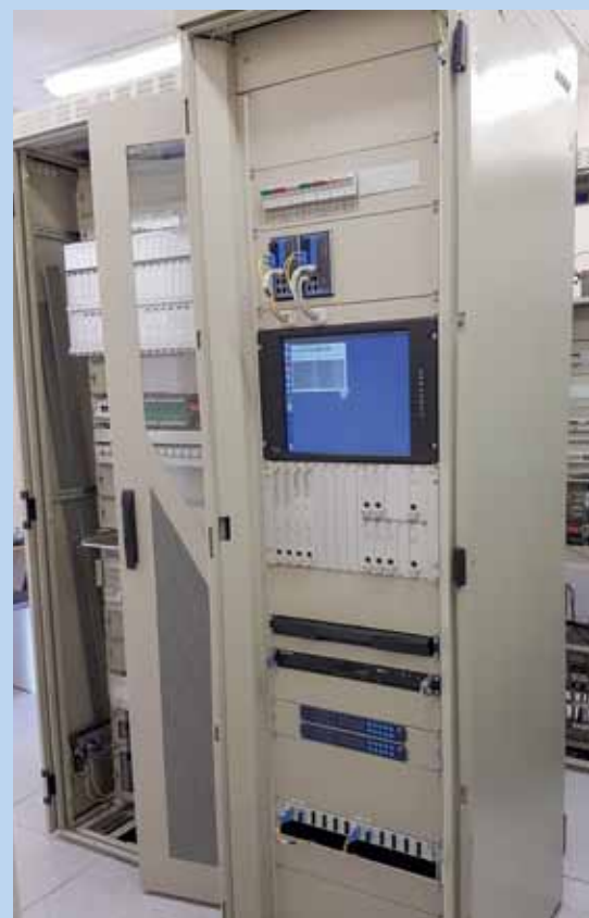
Oživené a aktivované jádro přejezdového zabezpečovacího zařízení PZZ-J ve stanici Muratli Muselles
