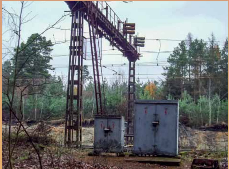
Reléové skříň autobloku vzor SSSR
