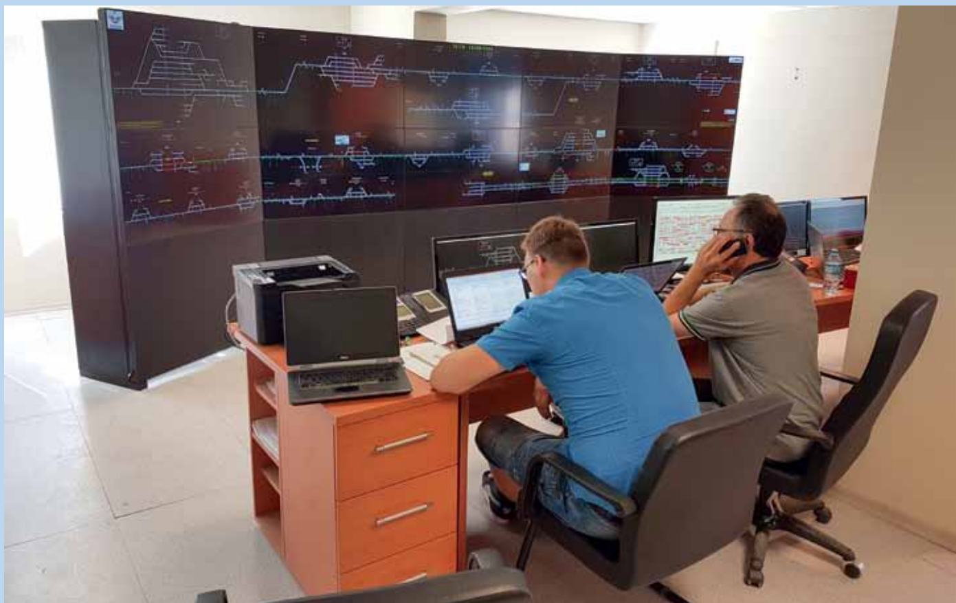
Velkoplošné zobrazení dálkového ovládní dodávaného firmou Abakus ve stanici Cerkezkoy. Z místního dispečerského pracoviště je ovládáno přes 300 km trati a přes 30 stanic včetně kompletního úseku Liman–Muratli zabezpečovaného AŽD Praha
