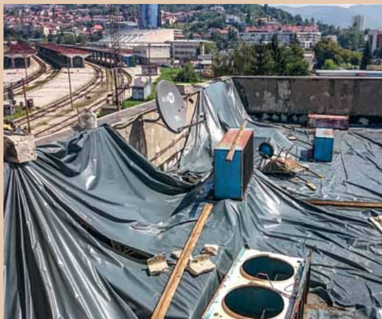
„Hydroizolace“ střechy reléové budovy s výhledem na nádraží v Sarajevu před rekonstrukcí
