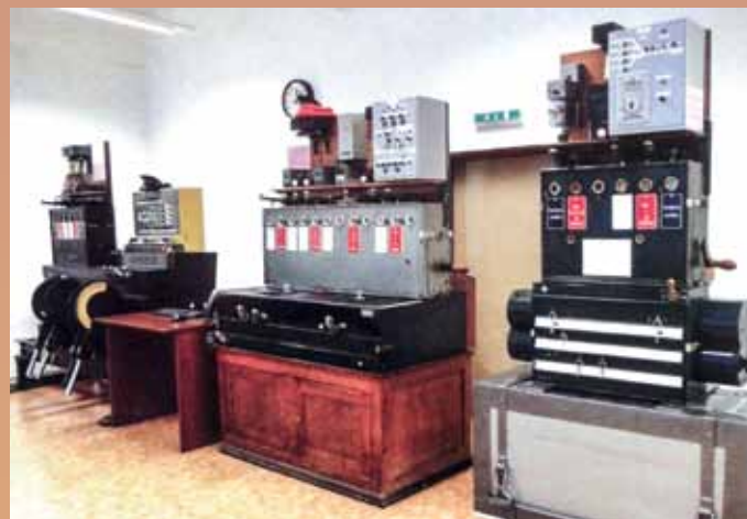
Po roce 1945 ve staniční zabezpečovací technice převažovalo elektro-mechanické zabezpečovací zařízení. Teprve od konce 60. let minulého století bývalo doplňováno o indikační kolejové desky (reprodukce z „Das Eisenbahnbetriebslabor der Fakultät Verkehrswissenschaften“, ČVUT, Praha, 2014)
