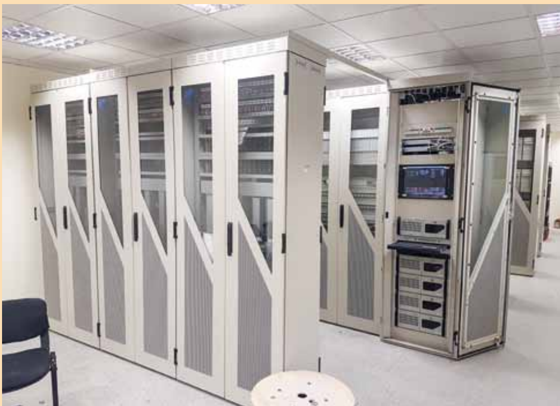
Staniční zabezpečovací zařízení ESA 44-TR
