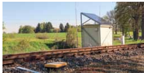
44 • ZKUŠENOSTI Z OVĚŘOVACÍHO PROVOZU ALTERNATIVNÍCH ZDROJŮ NAPÁJENÍ ZABEZPEČOVACÍCH ZAŘÍZENÍ
