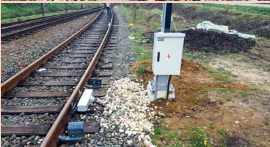
Nainstalovaný senzor počítače náprav a INDUSI magnetu ve stanici Ostružnja
