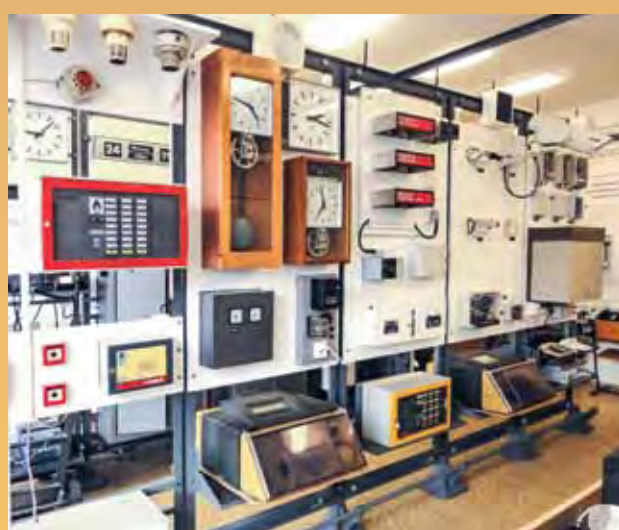
Elektrická požární signalizace
