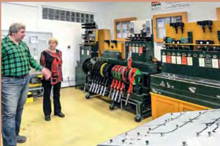
Elektromechanické zabezpečovací zařízení
