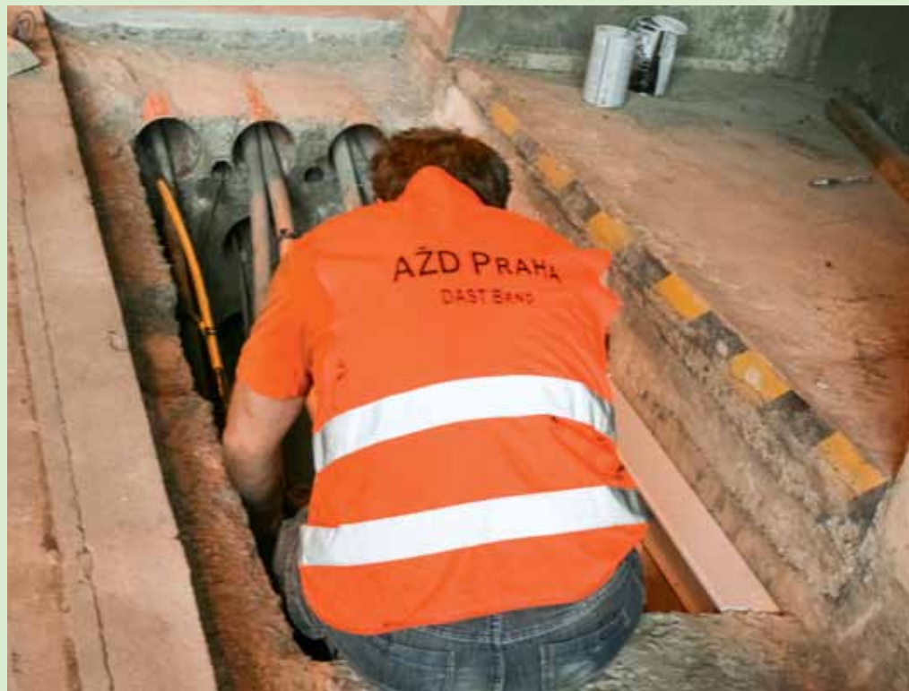
Omezený prostor pro práci v kabelových šachtách
