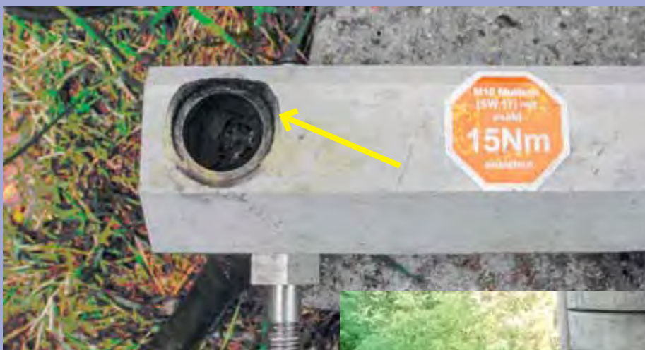
Místo přeskožení bleskového výboje z kolejnice přes čidlo snímače počítače náprav do zabezpečovacího zařízení
