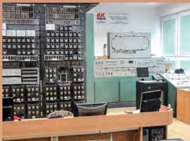
Staniční releové zabezpečovací zařízení a dálkové ovládání
