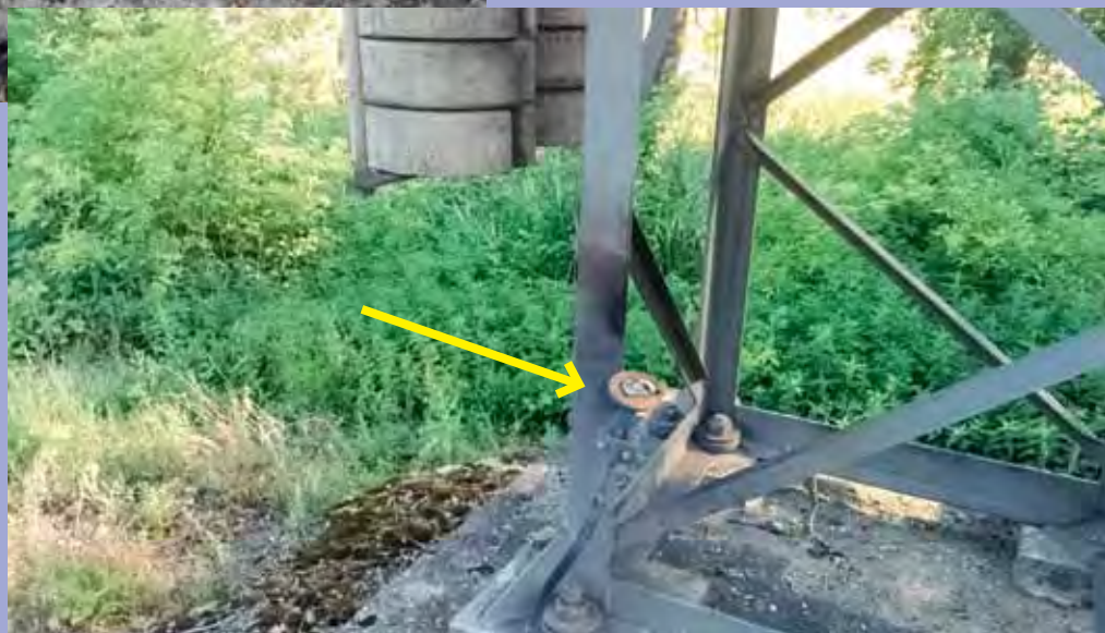
Zničená průrazka vlivem chybného zapojení růžkové bleskojistky přímo ke kolejnici namísto ke středu symetizační tlumivky SYT
