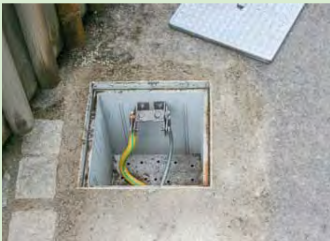
Revizní šachta s propojením zemní soustavy na zemní síť – vlevo kabel zemní soustavy, vpravo drát zemní sítě
