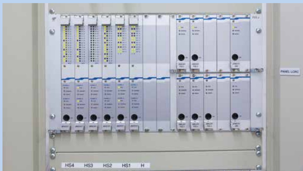
← Panel řídicího jádra přejezdového zabezpečovacího zařízení typu PZZ-J
