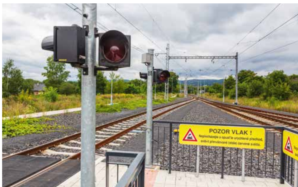
← Výstražné zařízení pro přechod kolejí v železniční stanici Louka u Litvínova
