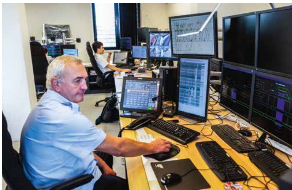
← Dispečerské pracoviště v železniční stanici Praha-Vršovice
