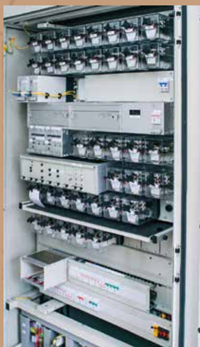
↑ Přístrojová skříň PZZ-RE
