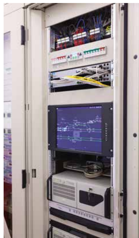
↓ Staniční zabezpečovací zařízení v železniční stanici Praha-Vršovice
