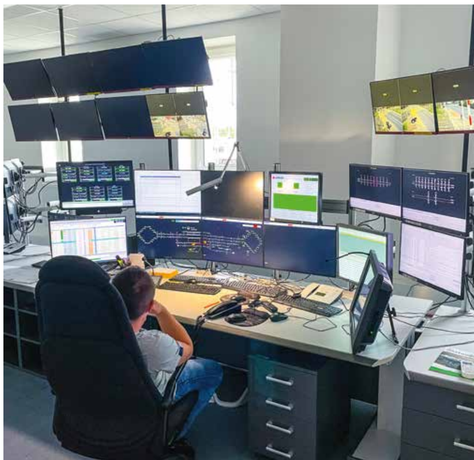
➔ Centrum dispečerského řízení LCS Poznań Główny III
