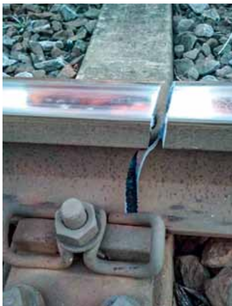
→ Obr. 8 Lom kolejnice na pod- kladnici (ten nemusí být vždy identifikován kolejovým obvo- dem)
