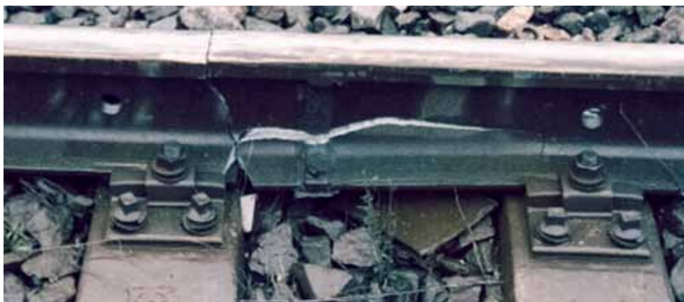
→ Obr. 1 Lom kolejnice
