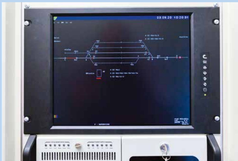
← Zadávací počítač údržby v železniční stanici Dětenice
