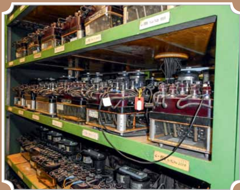
↓ Praha-Smíchov – reléové zabezpečovací zařízení
