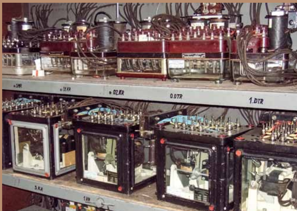
← Klasická zabezpečovací relé na autobloku Kolín–Praha
