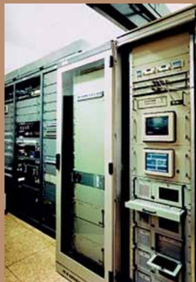
↓ Staniční zabezpečovací zařízení ETB
