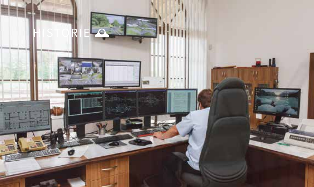
← Pracoviště výpravčího v železniční stanici Žatec se stavědlem typu ESA 44
