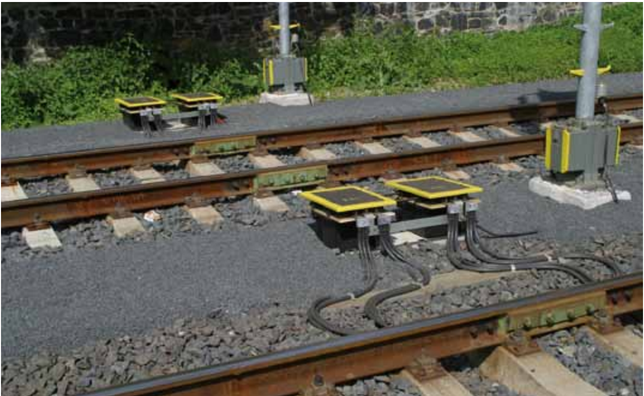
Stykové transformátory zapojené s kolejovými obvody
