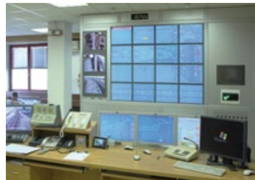
ESA 11M Control place
