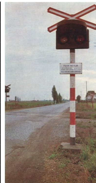
Světelné výstražníky automatického přejezdového zařízení VÚD
