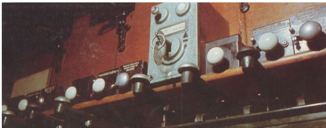
Detail hradlové skříně řídicího přístroje staničního elektromechanického zabezpečovacího zařízení
