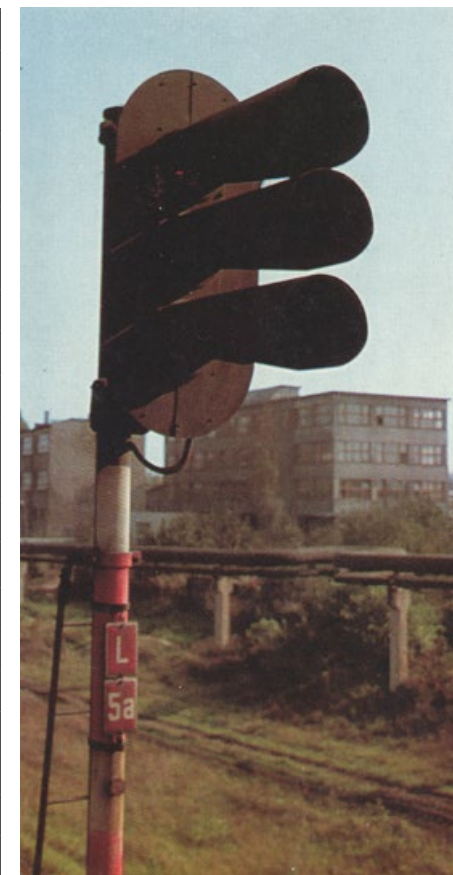
Hlavní světelné cestové návěstidlo reléového zařízení RPS-60
