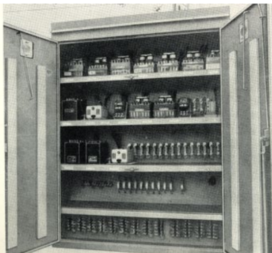
Reléová skříň a bateriová studna automatického přejezdového zařízení se závorami (vlevo)
