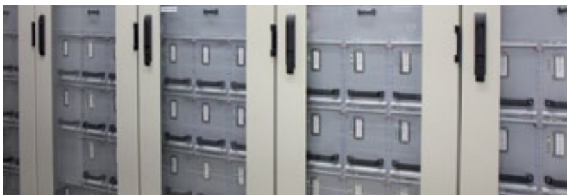
Централизационный пост ESA 11M+ шкафы технологических компьютеров
