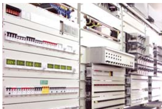
7 • NEJMODERNĚJŠÍ ZABEZPEČOVACÍ ZAŘÍZENÍ JE V HLUBOKÉ NAD VLTAVOU
