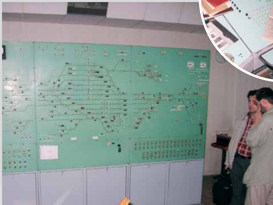
Původní zabezpečovací zařízení v Polocku
