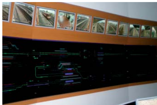
4 • ŽELEZNIČNÍ TRATĚ Z PŘEROVA DO POLANKY NAD ODROU JE NOVĚ ŘÍZENÁ DÁLKOVĚ
