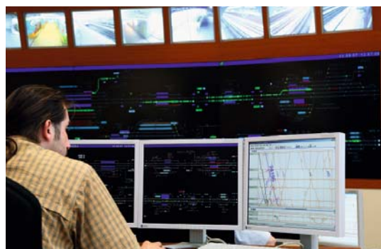
12 • AUTOMATICKÉ STAVĚNÍ VLAKOVÝCH CEST
