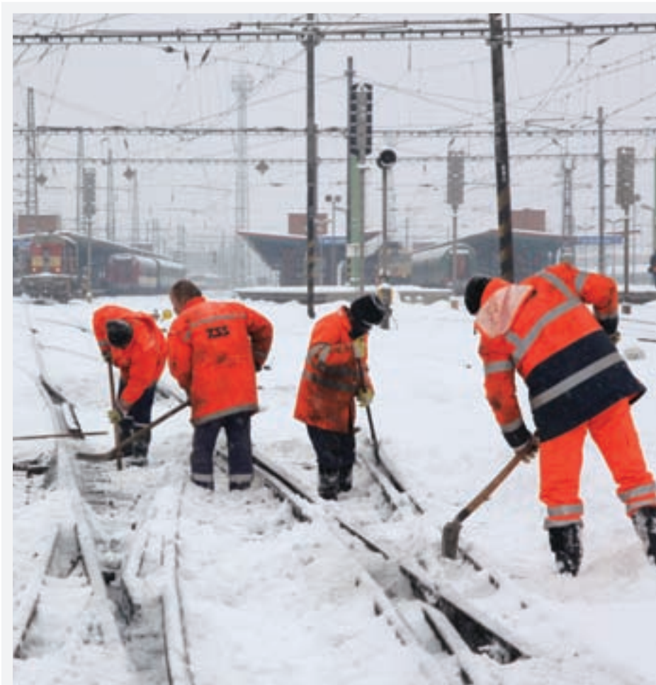
Údržba se měla co ohánět
