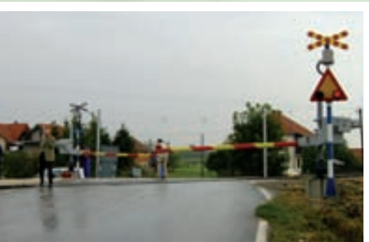
Železniční přejezd AŽD Praha v Srbsku
