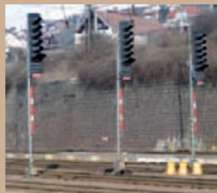
Návěstidla AŽD 70 s indikátorem v žst. Bratislava hlavní stanice
