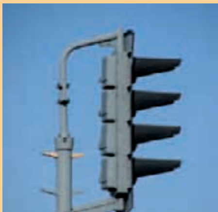
Návěstidlo vzoru AŽD 70 v žst. Hlohovec
