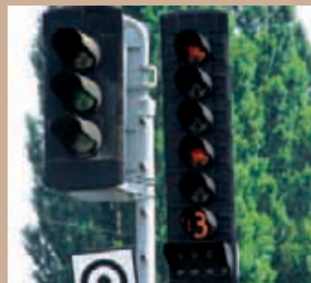
Návěstidla AŽD 70 ve funkci „autobloku“ a se světlem pro návěstění rychlosti 30 km/h v Muzeu sdělovací a zabezpečovací techniky v Hradci Králové
