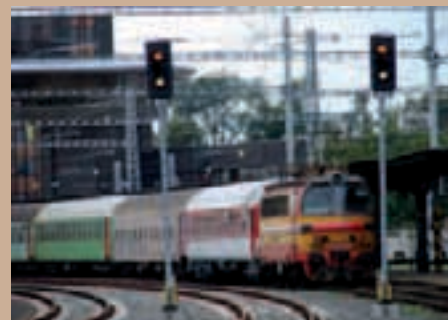
Opakovací návěstidla OPrLc101 a OPrLc102 AŽD 70 inovované konstrukce v žst. Trnava
