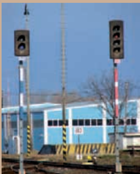
AŽD 70 – Návěstidla Se6 a L3 žst. Hlohovec v nebezpečném osvětlení vycházejícího slunce, které může ovlivnit viditelnost návěsti
