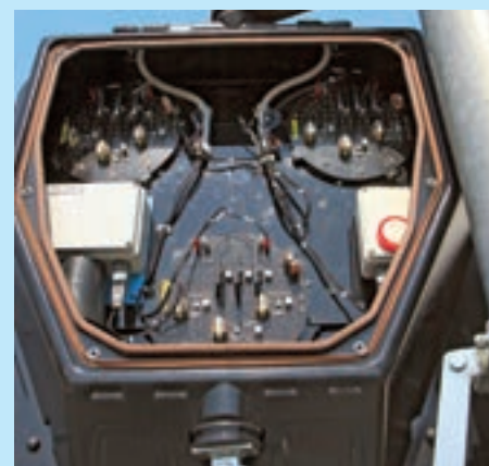
Pohled do výstražníku – umístění elektroniky LED
