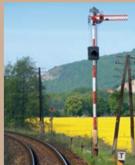
Mechanické návěstidlo se světelnou přivolávací návěstí AŽD 70, Bystřičany
