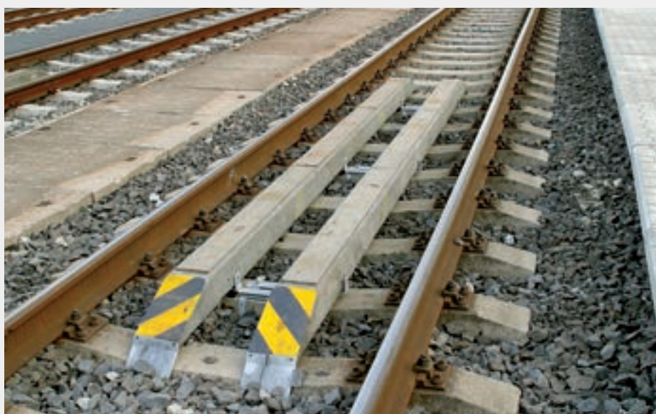
Magnetický informační bod MIB-6, sloužící pro orientaci systému AVV (v rámci Pilotního projektu ETCS je zkoušena orientace systému AVV pomocí balíz ETCS)
