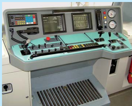
Uprostřed stanoviště strojvedoucího vidíte klávesnici AVV
