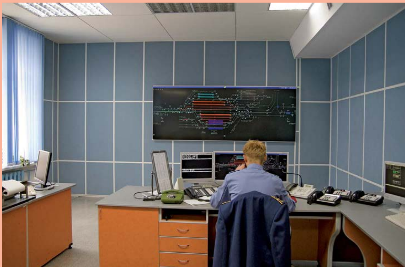
Jedna z prvních instalací AŽD Praha v Bělorusku, dopravní kancelář v železniční stanici Polock
