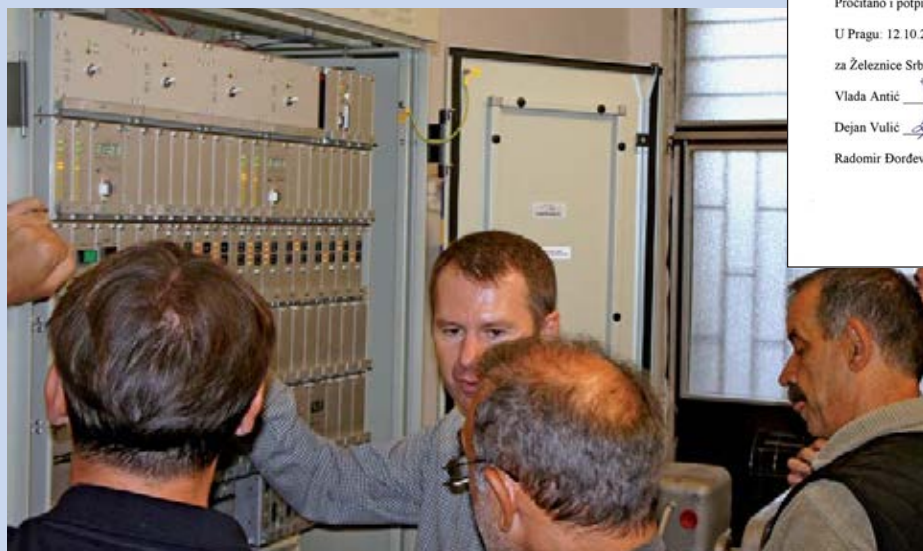
Tovární zkouška PZZ-EPA
