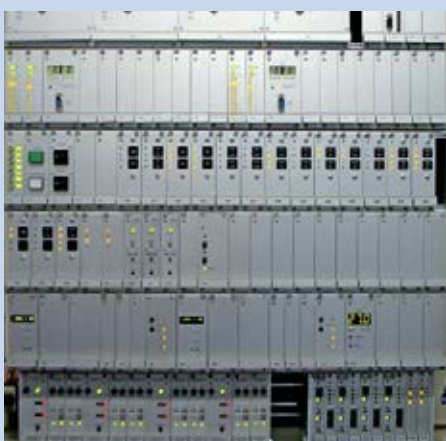
Technologie přejezdového zabezpečovacího zařízení PZZ-EPA
