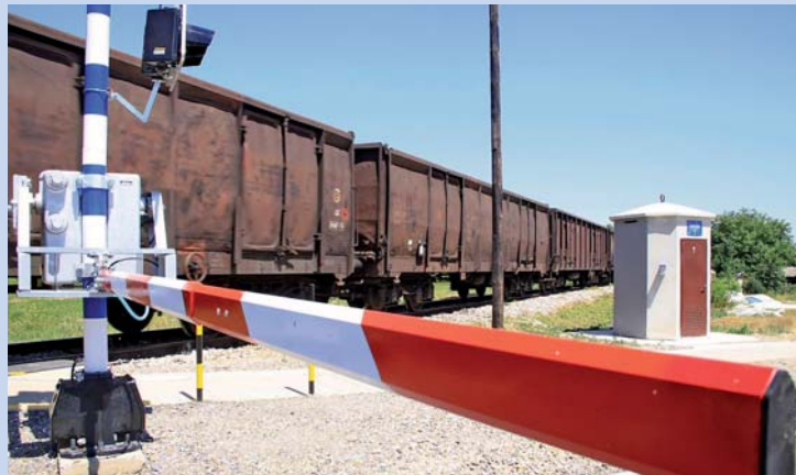
Jeden z typických srbských přejezdů, které v budoucnu budou napojovány na PZZ-EPA
