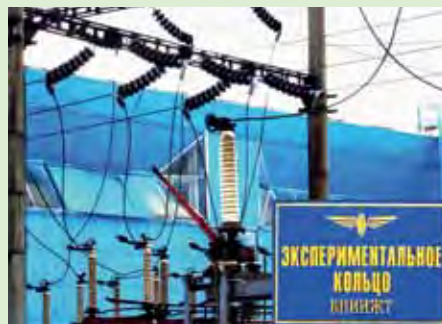
Obr. 7 Venkovní rozvodna 110 kV napájecí stanice ve Ščerbince. Foto z března 2005
