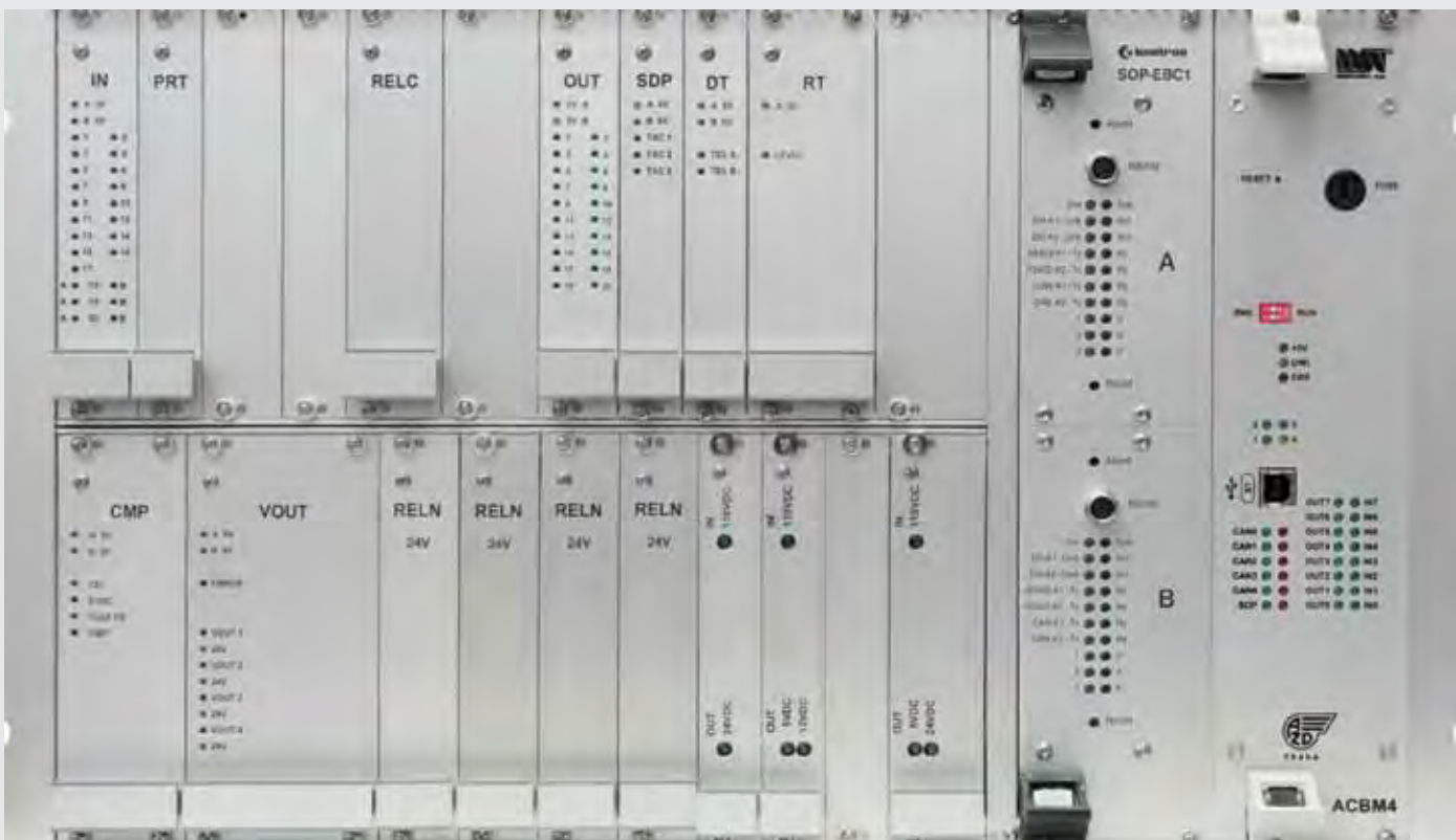
Kompletní vlakový zabezpečovač SOP-3 se zasunutým modulem ACBM4W
