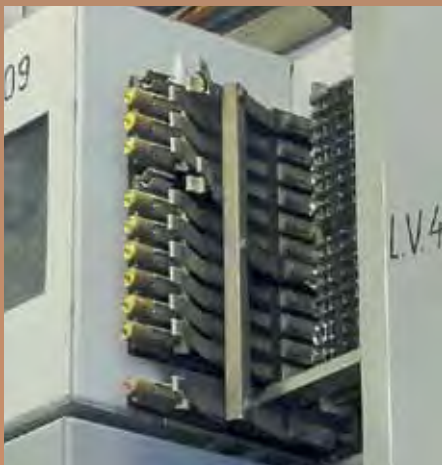
Optická indikace přerušného vlákna pojistky byla v „klasických“ ATU samozřejmostí. V zabezpečovací technice se začala využívat až od 60. let 20. století
