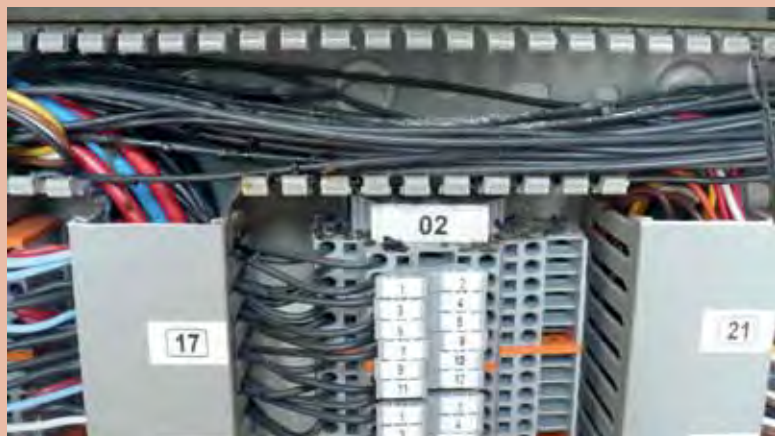
PZZ „F“, poškození vnitřní kabeláže hlodavci
