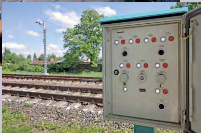
Panel nouzového ovládání přejezdu
