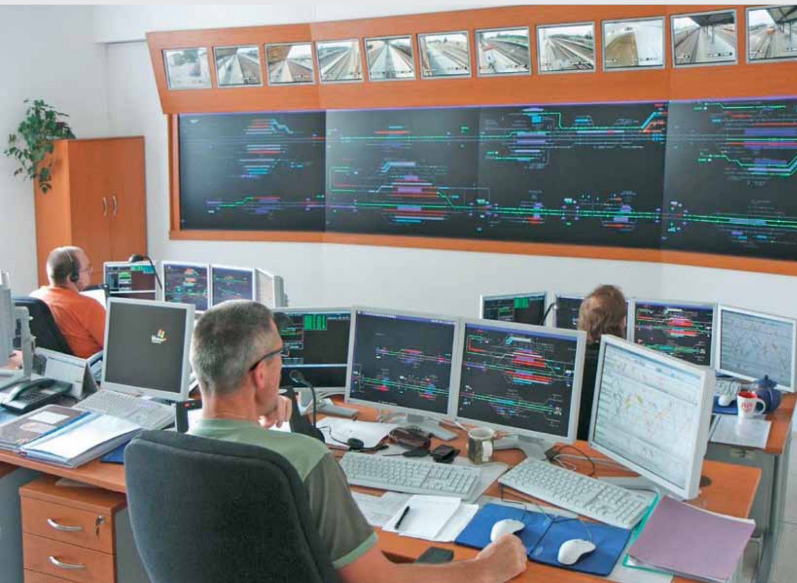
Obr. 8 Centrální dispečerské pracoviště v Přerově, sál řízení tratě Ostrava–Přerov
