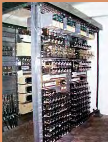
Stojanové řady elektronického staničního zabezpečovacího zařízení s reléovou prováděcí částí – typ K-2000 společnosti Starmon (reprodukce z firemního prospektu)
