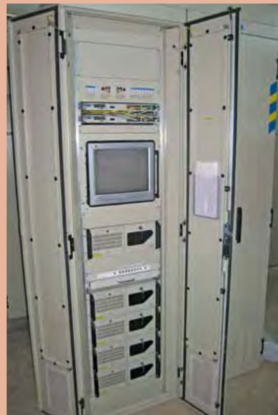
Staniční zabezpečovací zařízení ESA 44-BC
