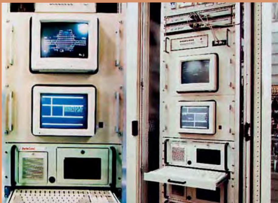
Pracoviště údržby a servisu u elektronických zabezpečovacích zařízení společnosti AŽD Praha (reprodukce z prospektu AŽD Praha)
