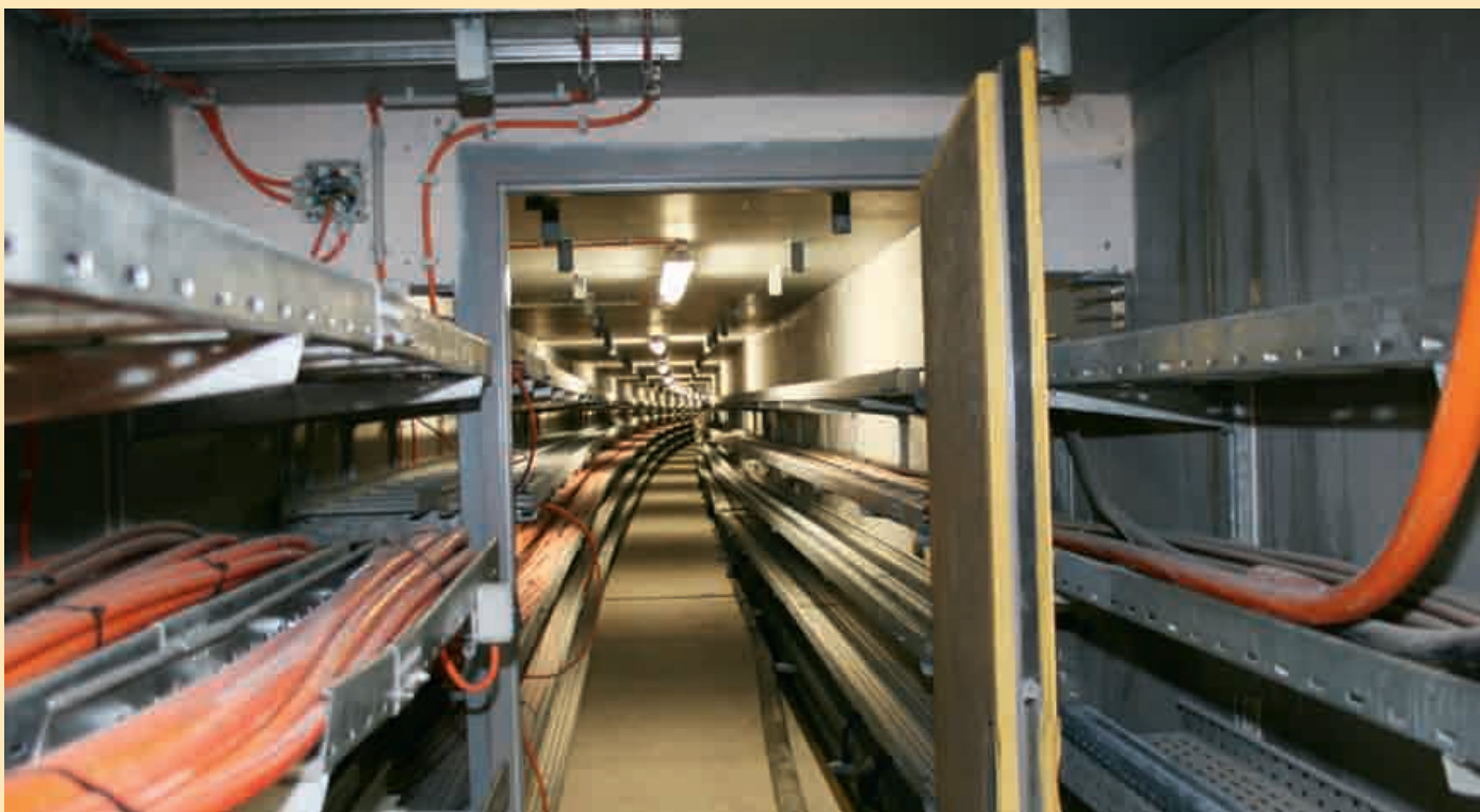
Kabelové trasy v technologických chodbách – únor 2013
