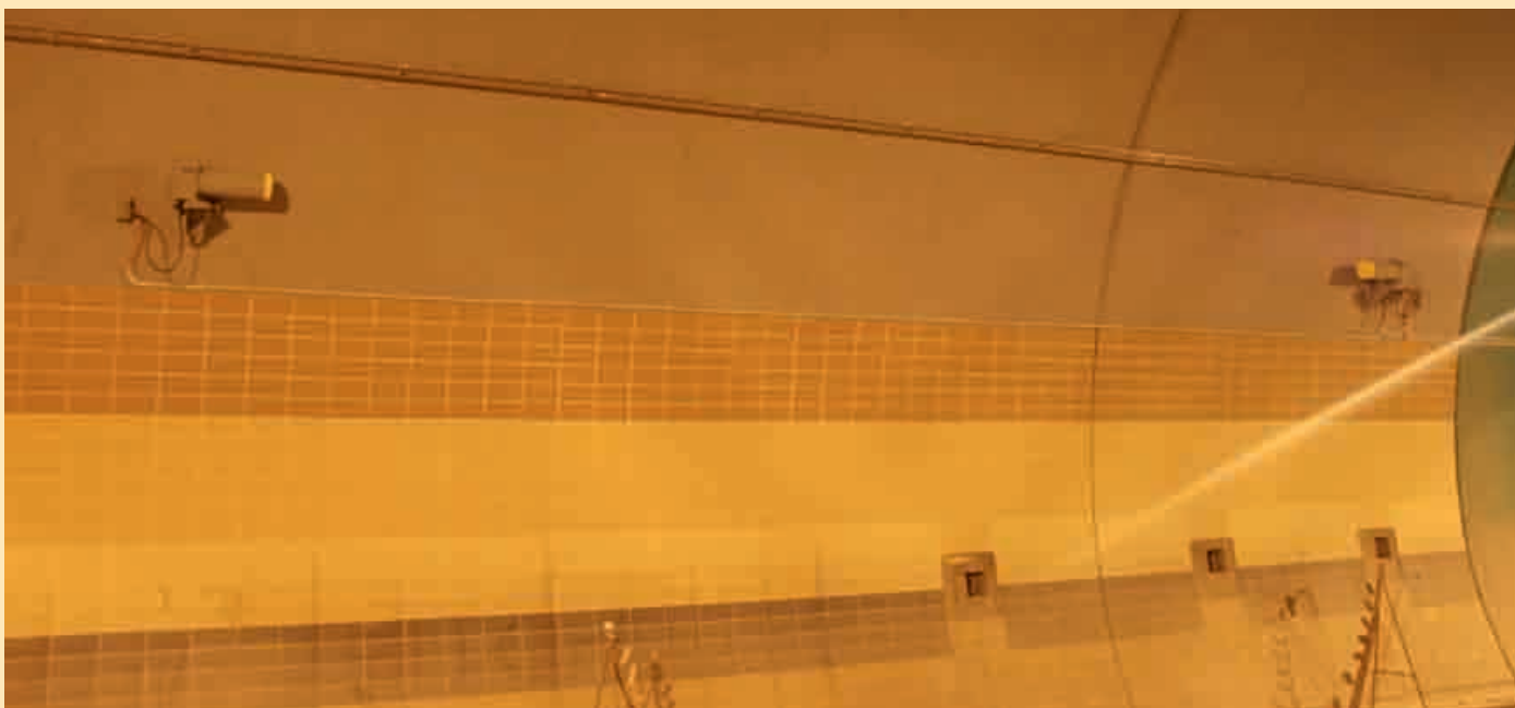
Zařízení pro měření proudění vzduchu a opacitu (sledování optického znečištění vzduchu) – září 2013
