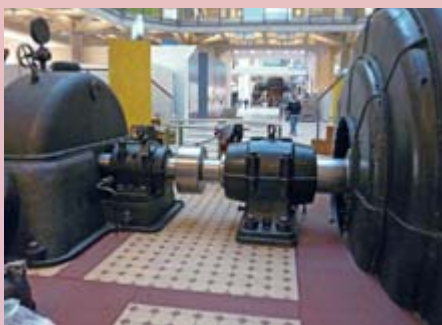
Soustrojí pro napájení elektrizované trati z vodní elektrárny
