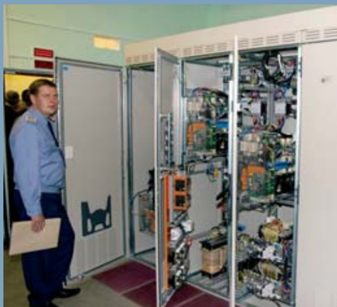
Systém UNZ (univerzální napájecí zdroj) vyrobený již v kooperaci s Brestským elektrotechnickým závodem
