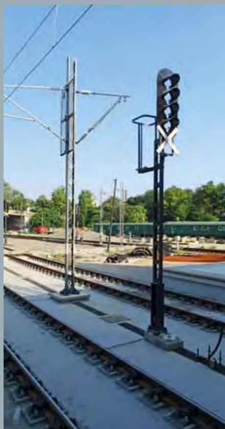
Hlavní návěstidlo připravené na montáž nových LED modulů LLA2-SB
