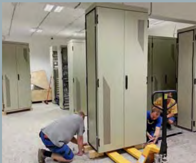
Rozmístění skříní ve stavědlové ústředně
