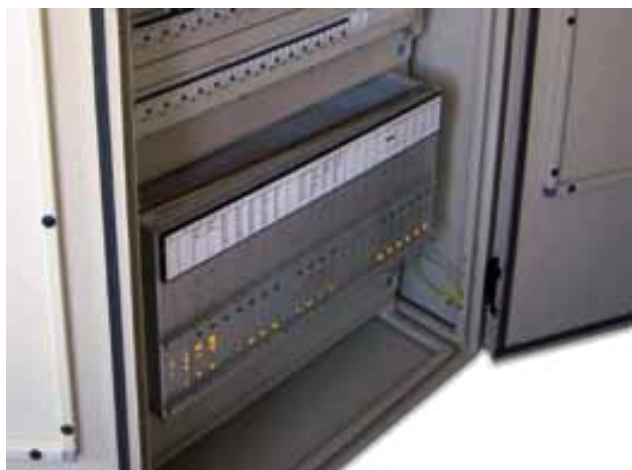
Prováděcí část stavědla ESA® 33
