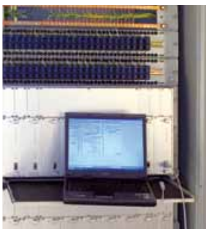
Stojan s kolejovými přijímači TCR a diagnostickým PC
