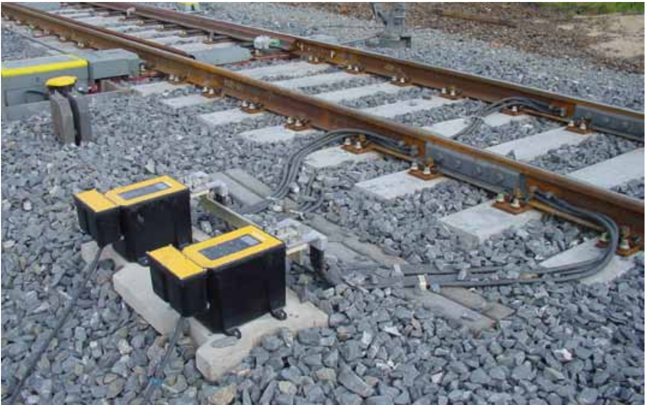
Stykové transformátory zapojené s kolejovými obvody
