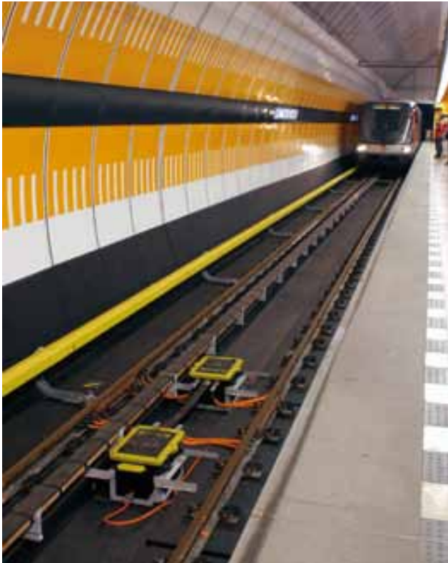
Stykové transformátory v kolejišti stanice metra
