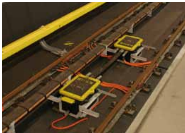
Stykové transformátory STM 0,93 B
