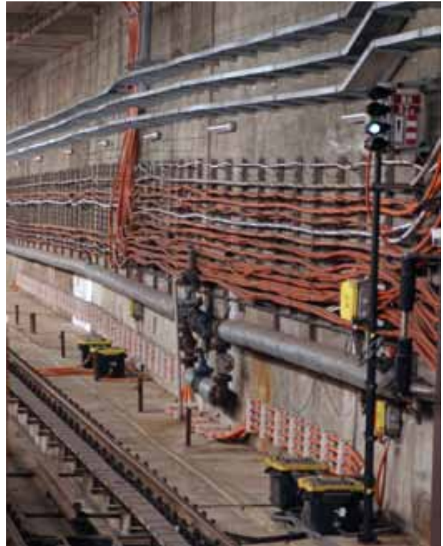
Stykové transformátory na trati metra
