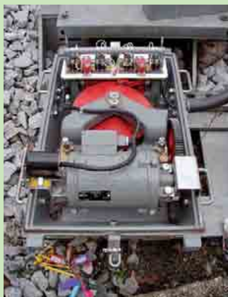
Vnitřek přestavníku i po dvouletém provozu vypadá, jako by právě sjel z výrobní linky
