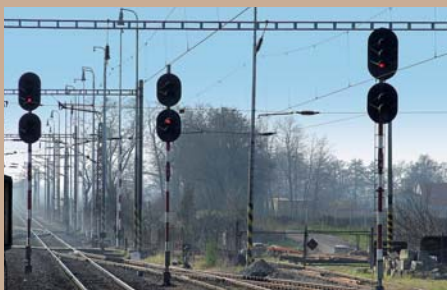
Návěstidla vzor SSSR s „trafozákladem“ AŽD vz. 65 a se svorkovnicí ESP/ČKD, Cífer
