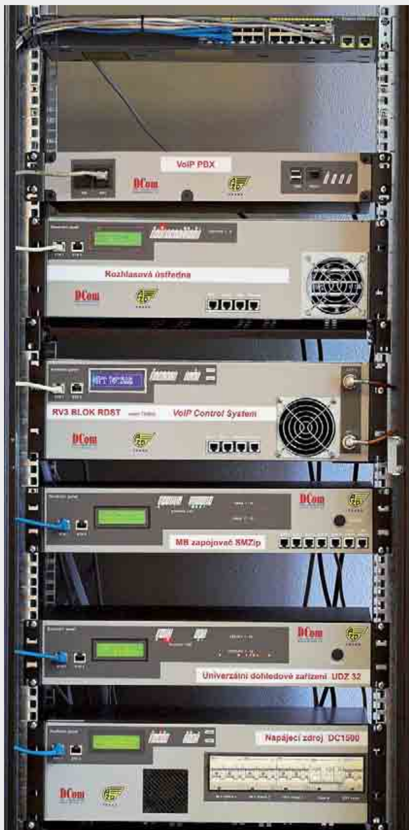
Obr. 2 Rozváděč integrovaného systému Radiovoice 3
